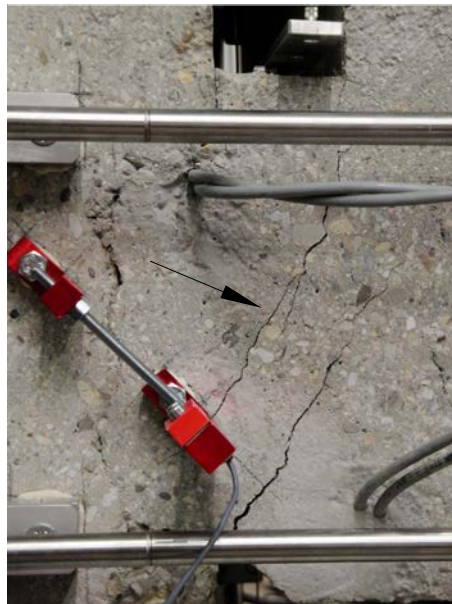
(b) Fissuration de la bielle de compression, à 500 kN
